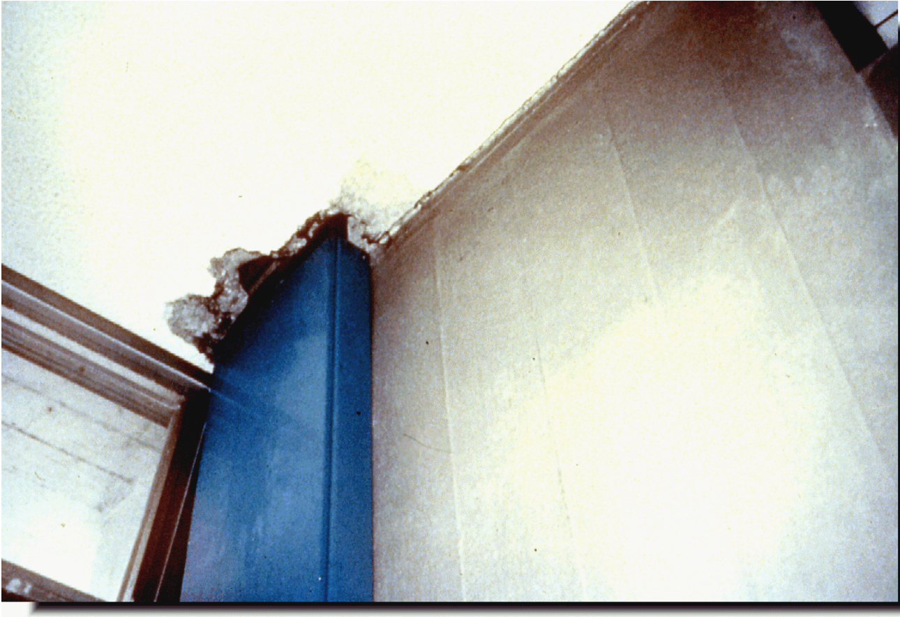
Figura 13 – Degrado spontaneo di solaio contenente amianto
